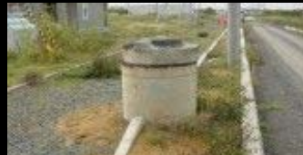
浮力が生じ、マンホール等が浮き上がる。
